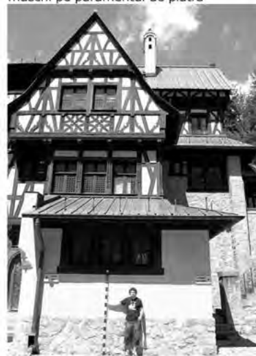
Acoperis de protectie realizat ulterior greutatea lui a provocat fisuri in parament
