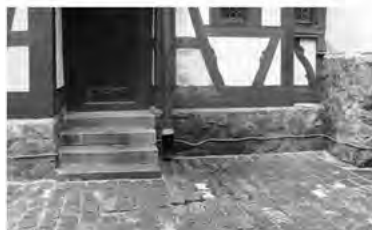
Soclu piatra infiltratii de apa meteorica
