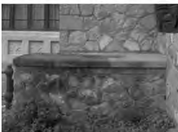
Soclu piatra cu infiltratii ape meteorice
