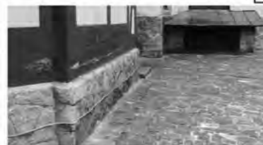
Soclu piatra infiltratii de apa meteorica Acoperis din tabla pentru protectia aerisirii de subsol- zona cu umezeala ascensionala, muschi pe paramentul de piatra
