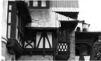
Acoperis de protectie realizat ulterior greutatea lui a provocat distrugerea balustradelor si fisuri in parament
