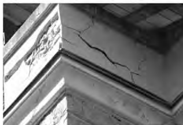
Acoperis de protectie realizat ulterior greutateablu a provocat fisuri in parament
