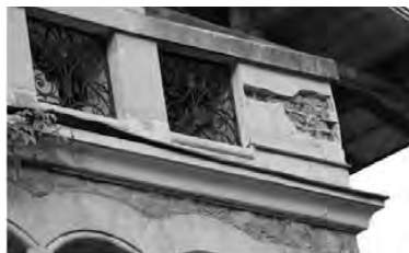
Acoperis de protectie realizat ulterior greutateablu a provocat fisuri in parament
