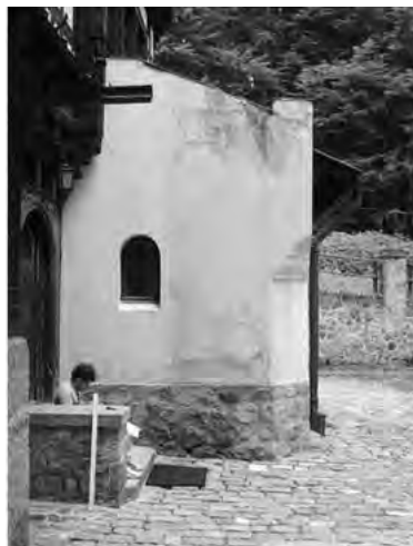
Tencuiala scorojita, degradata, infiltratii de apa meteorica
