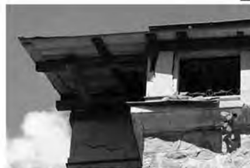
Acoperis de protectie realizat ulterior vegetatie parazitara, brau deriorat.
