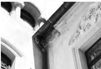
Degradari cauzate de ifiltratiile de apa, igheaburi si burlane degradate
