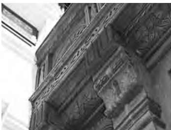
Lemn degradat, vopsitorie scorojita, eflorescente de culoare alba
